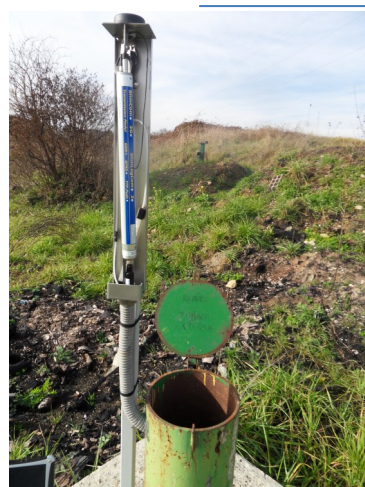
Piezomètre N20 (Fontoy) équipé d'une sonde pression et module de télétransmission
