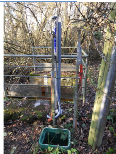
C5 galerie du Woigt équipée d'une sonde pression / conductivité et télétransmission
